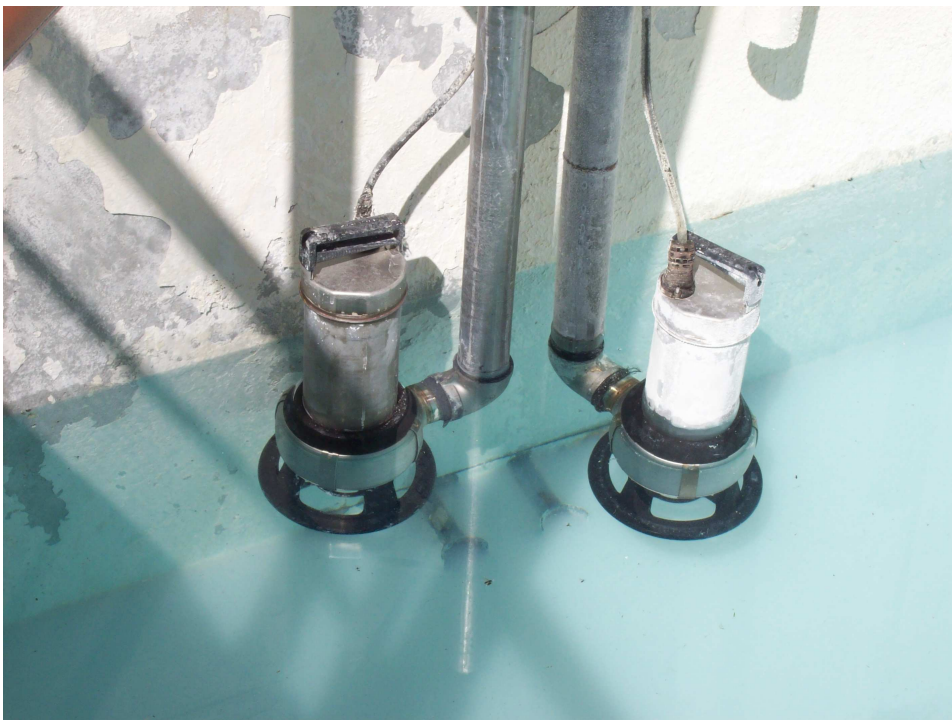
Foto 2. Bombas de impulsión; elevan el efluente a la etapa de coagulación y floculación.
